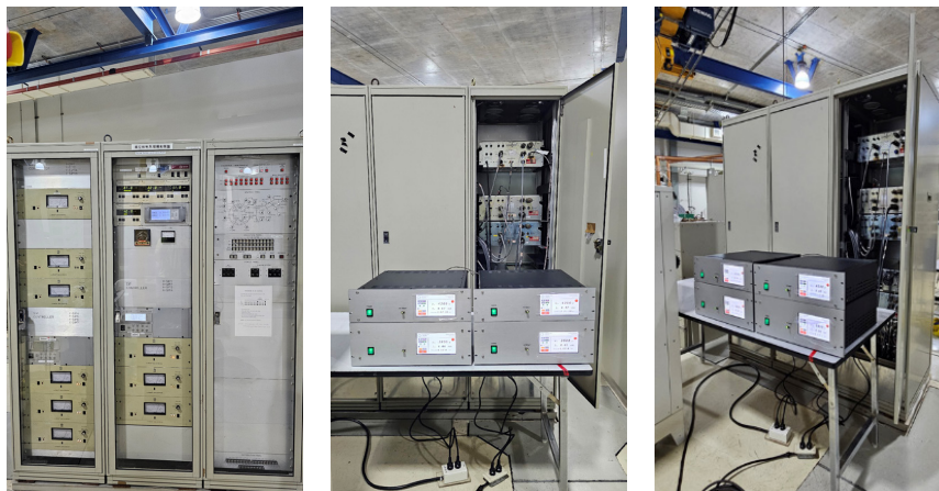
รูปที่ 7 การติดตั้งใช้งานจริงร่วมกับเครื่องกำเนิดแสงซินโครตรอน บริเวณ Booster Synchrotron
