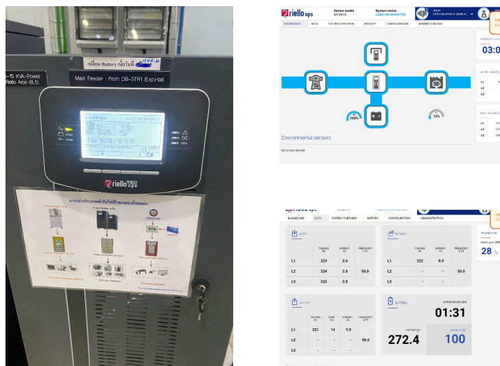
รูปที่ 15 ระบบ UPS monitoring system
