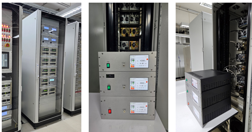
รูปที่ 8 การติดตั้งใช้งานจริงร่วมกับเครื่องกำเนิดแสงซินโครตรอน บริเวณ Storage Ring
