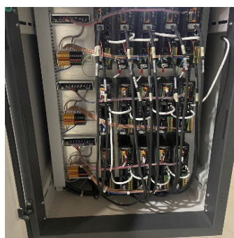
รูปที่ 16 ชุดควบคุมมอเตอร์อัตโนมัติสำหรับปรับตำแหน่ง Girder
